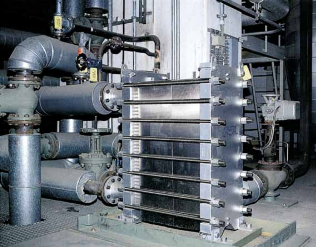
Almanya'da bulunan Staudinger Kraftwerk, türbinin çalıştırılması esnasında mümkün olduğu kadar hızlı ve yüksek kalitede buhar elde etmek amacıyla tamamı lazer kaynaklı AlfaRex Isı değiştiricisine yatırım yapmıştır.
